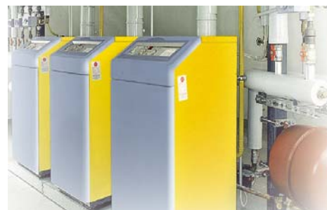
Figura 1. Gruppo di caldaie a condensazione alimentate a gas metano.
